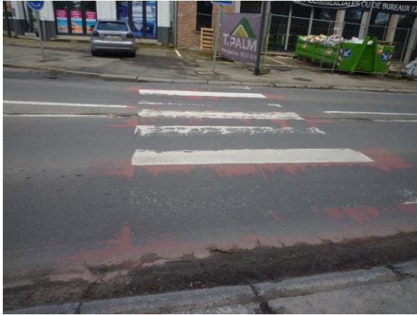
Photo 12. Traversée piétonne et trottoirs en mauvais état chaussée de Wavre, à proximité du rond-point
